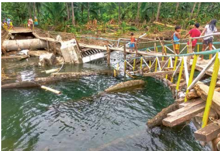
Il più recente ciclone abbattutosi sulle Filippine ha danneggiato gravemente molte infrastrutture.
